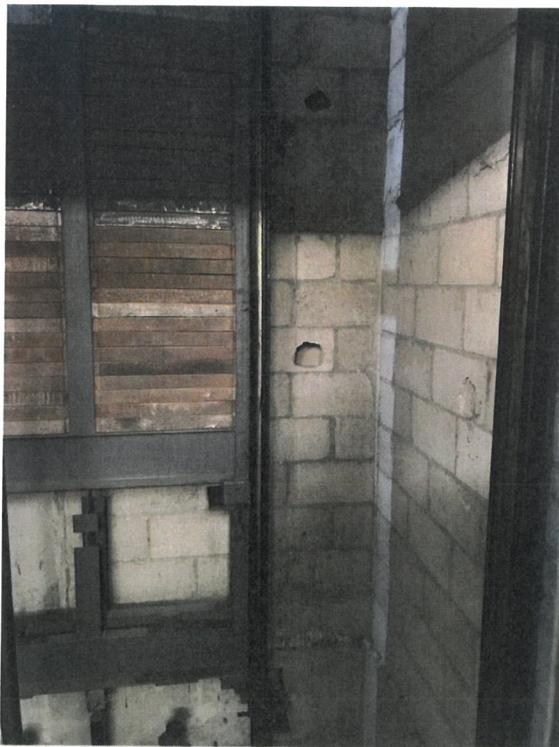
Desprendimiento y formación de oquedades en cubo de elevadores, sin que se afecte la verticalidad ni la estabilidad de la estructura.
