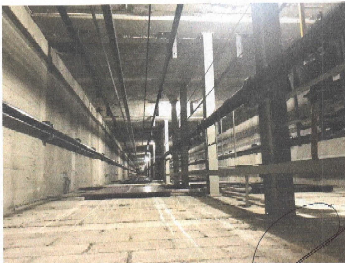
Fosas de elevadores sin deformaciones visibles o medibles
