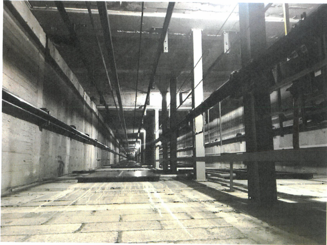
Fosas de elevadores sin deformaciones visibles o medibles.
